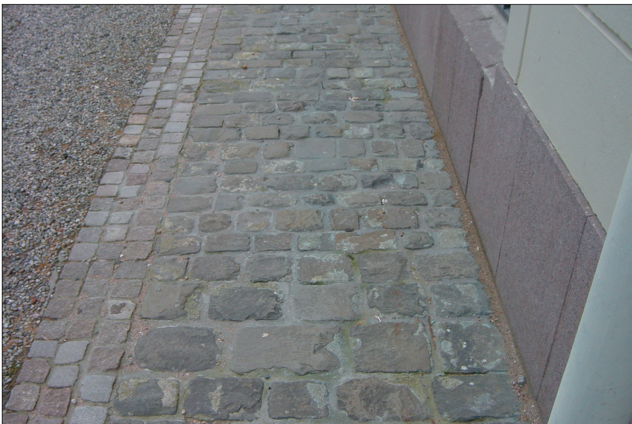
Bilde 27: Grønnsteinsbelegg rundt sokkelen av slottet
